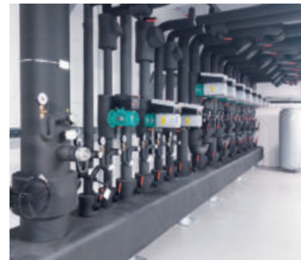
Die Kälteanlage sorgt für eine ausreichende Kühlung der IT-Infrastruktur.
