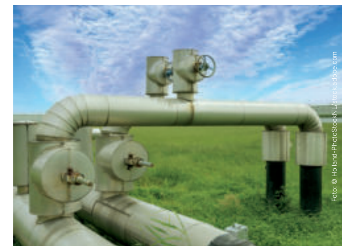
Die Abwärme kann z.B. in ein Wärmenetz zur kommunalen Wärmeversorgung gespeist werden.
