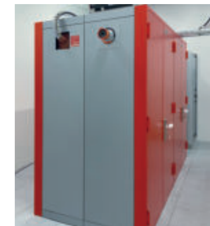
Die Brandschotts verhindern Feuer- und Rauchausbreitung ins Innere.
