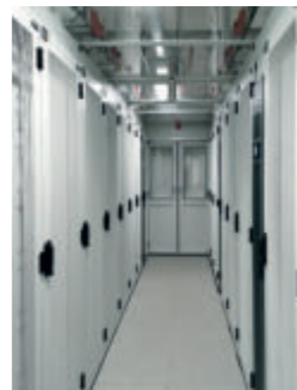
Strikte Trennung von Warm- und Kaltluft durch Kaltgangeinhausung.
