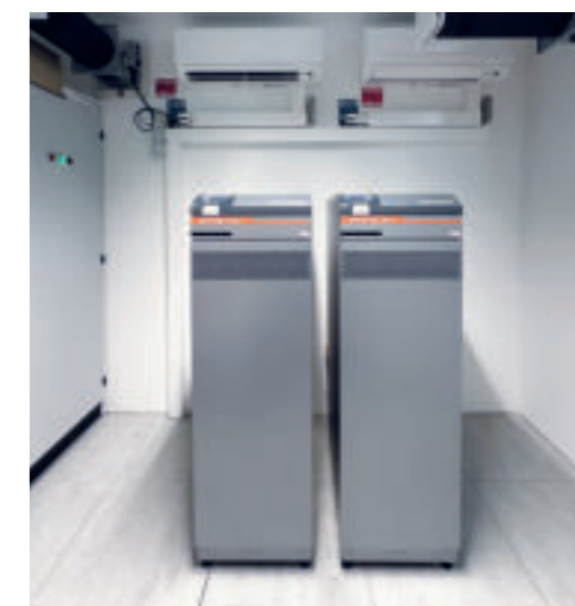
USV-Anlagen sorgen für eine ständige, unterbrechungsfreie Stromversorgung.
