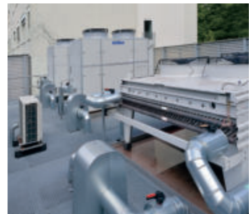
Auf dem Dach des Trafo-Gebäudes finden Kältekomponenten und Versorgungsstrassen ihren Platz.
