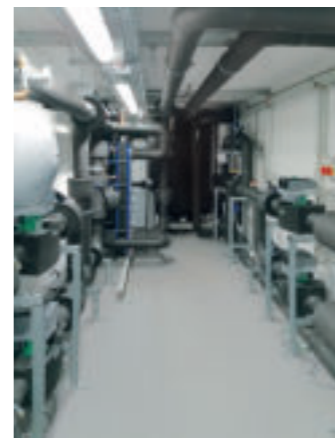
Kältezentrale des Rechenzentrums im Zwischengeschoss.
