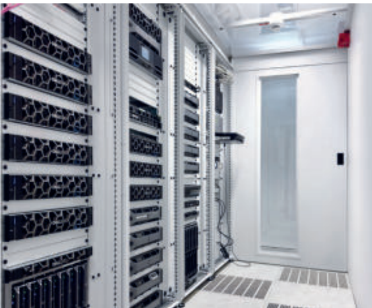
Kalt-/Wärmegangeinhausung zur optimalen und energieeffizienten Luftführung.
