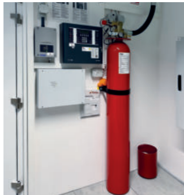
Brandfrüherkennungssystem inkl. NOVEC 1230 Feuerlöschanlage mit Brandmeldeanlage.
