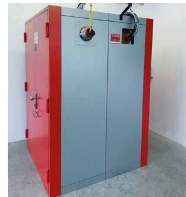
Die LESCOM-Experten bieten maßgeschneiderte Kundenlösungen von der Einzelanlage bis zum Gesamtpaket.
