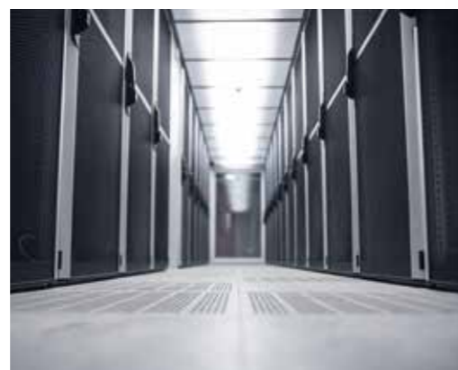
Ein wegweisendes Konzept: Der Mietvertrag sieht drei Anmietungsstufen von Flächen für jeweils rund 100 Server-Racks vor.
