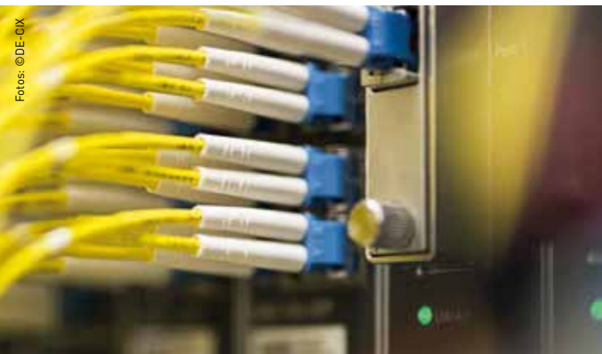
An den Internetknoten werden mittels DE-CIX Kabeln und Patchpanels verschiedene Netzwerke miteinander verbunden.
