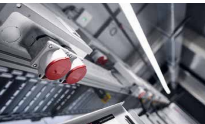
Alle Gewerke greifen perfekt ineinander: Modernste Technik und ein besonderes Nachhaltigkeitskonzept sorgen für einen sicheren Rechenzentrumsbetrieb.
