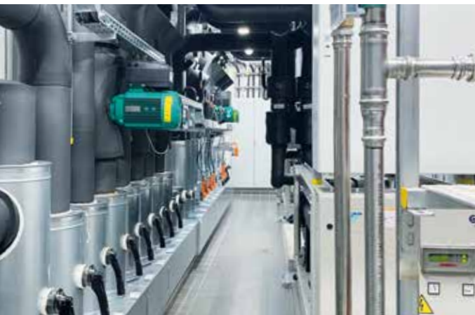
Durch gezielte Reengineering-Maßnahmen konnte die RZservices eine deutliche Energieeinsparung im Hörmann-Rechenzentrum erzielen.
